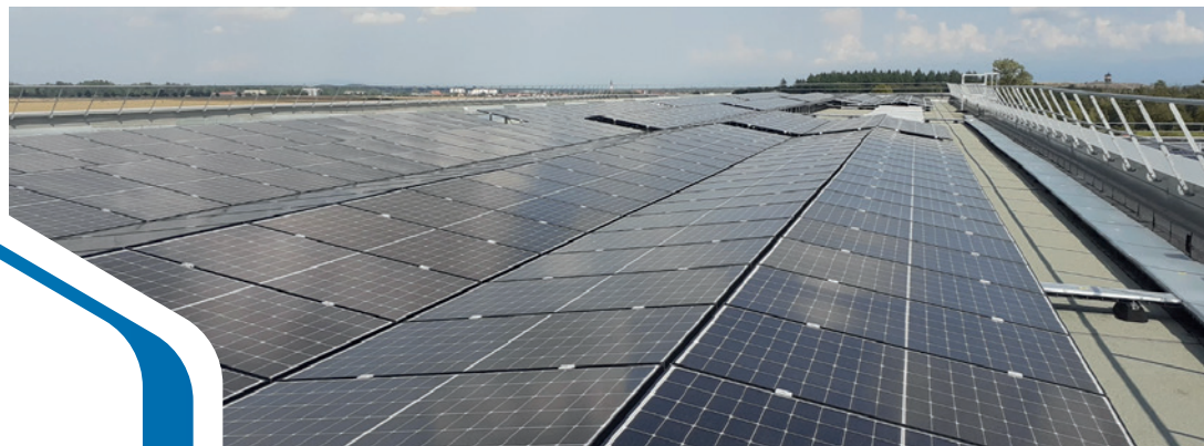
Panneaux solaires de l'agence de Cernay (68)
